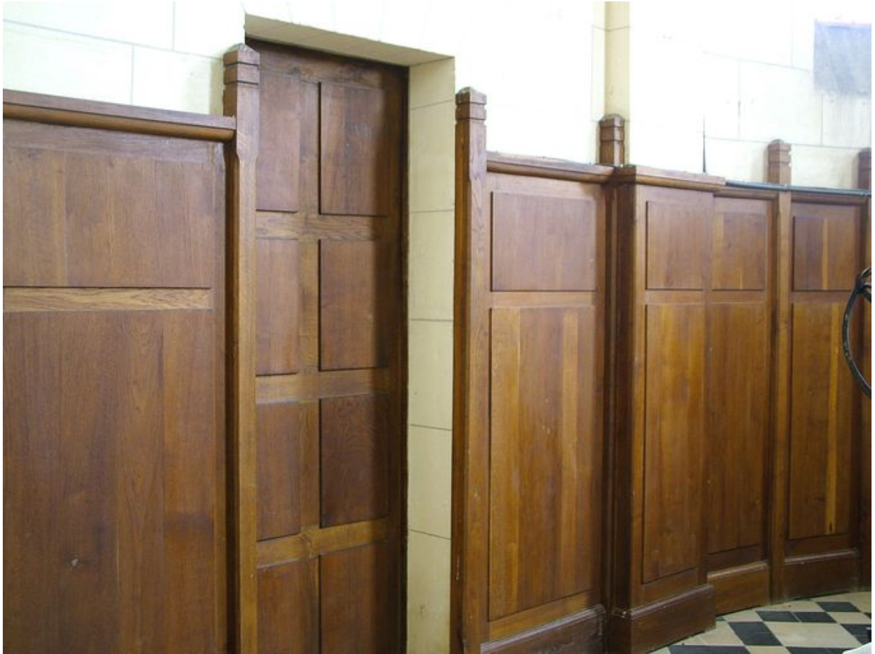
Vue des lambris de demi-revêtement dans le chœur et porte de la sacristie.
