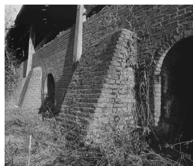
Façade ouest du four industriel avec contreforts en briques. Phot. Franck Bürjes IVR22_19986000265X
