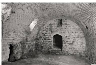
Vue générale du 1er niveau de cave, couvert d'une voûte en berceau plein-cintre en brique. Phot. Pierre-Yves Brest IVR22_19990202101Z
