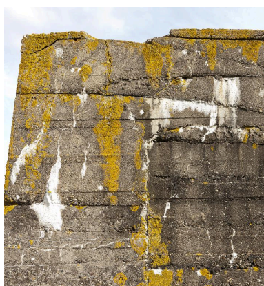
Raccord de plans de coulée sur l'élévation sud Phot. Jean-Marc Ramette IVR31_20145904572NUCA
