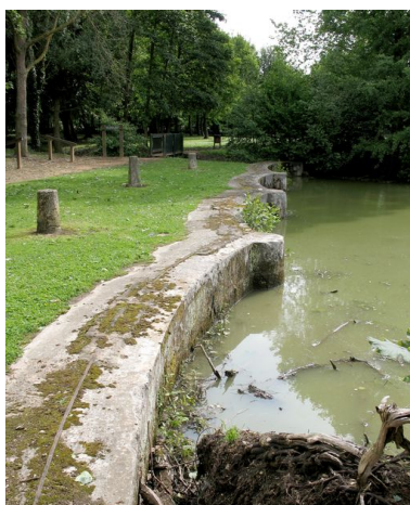
Usine III : Le déversoir en pierre qui permettait d'alimenter les bras d'eau de la Brèche en amont du moulin du château est construit avant 1810. Phot. Clarisse Lorieux IVR22_20096005037NUCA
