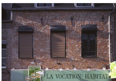
Vue de fers d'ancrage sur une maison indéterminée. Phot. Thierry Lefebure IVR22_19990206252XA
