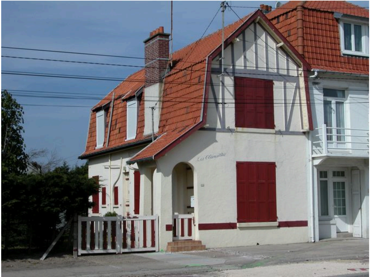
Le gros-oeuvre recouvert d'un enduit peint de couleur blanche (Les Clématites, 360 avenue de la Plage).
