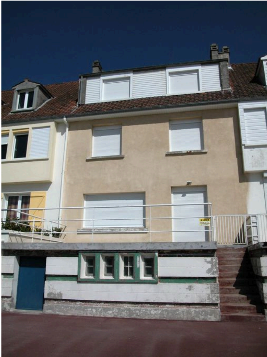
Quelques traces d'ancienne peinture verte sur le soubassement (maison 230 bd Maritime Sud).
