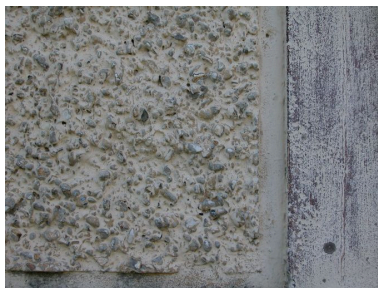
Détail du mur de la maison L'Espérance avec un mélange de petits galets (109 rue Molière). Phot. Elisabeth Justome IVR22_20058003801NUCA
