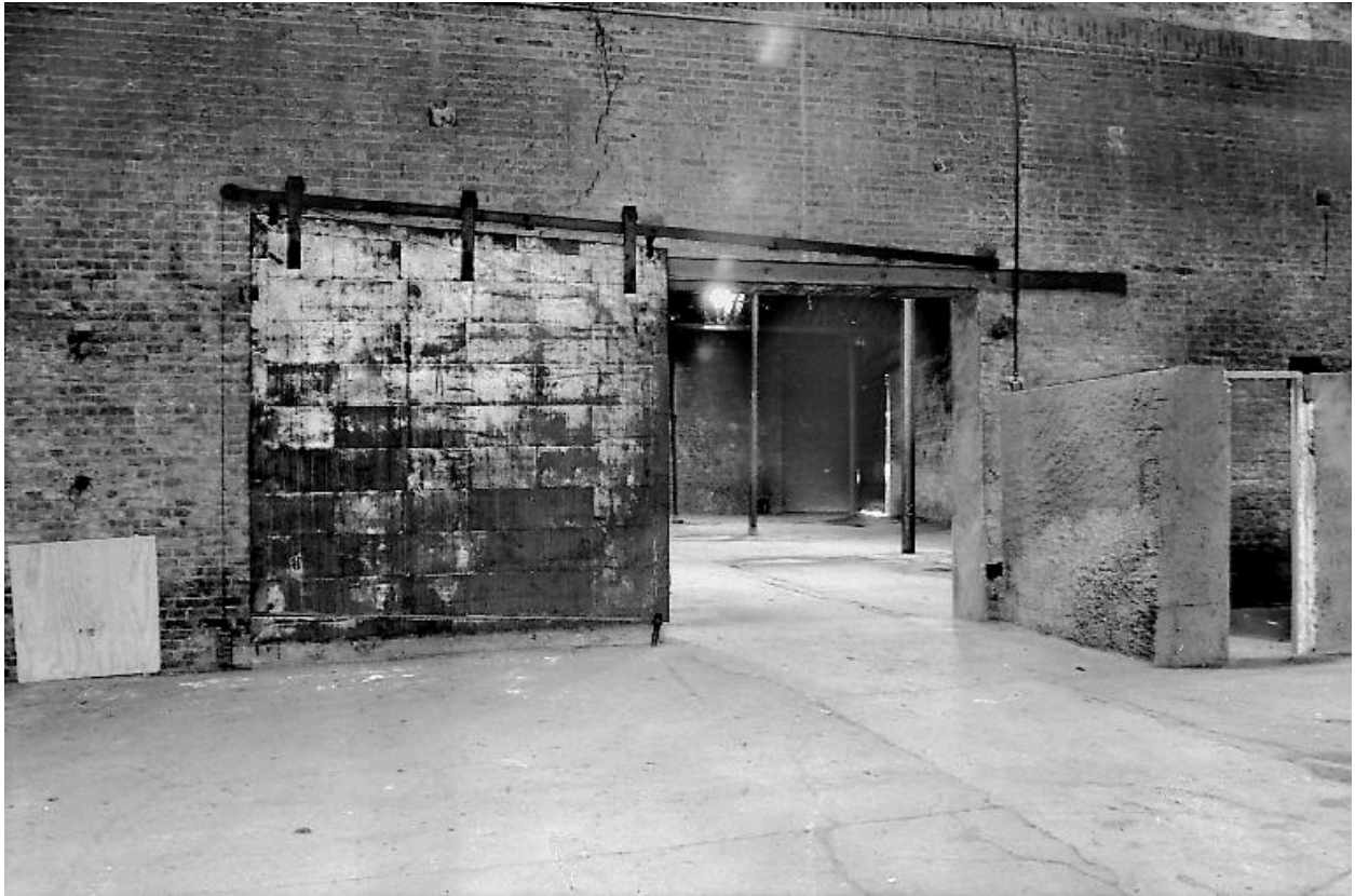
Entrepôt industriel. Vue intérieure. Porte inifugée.
